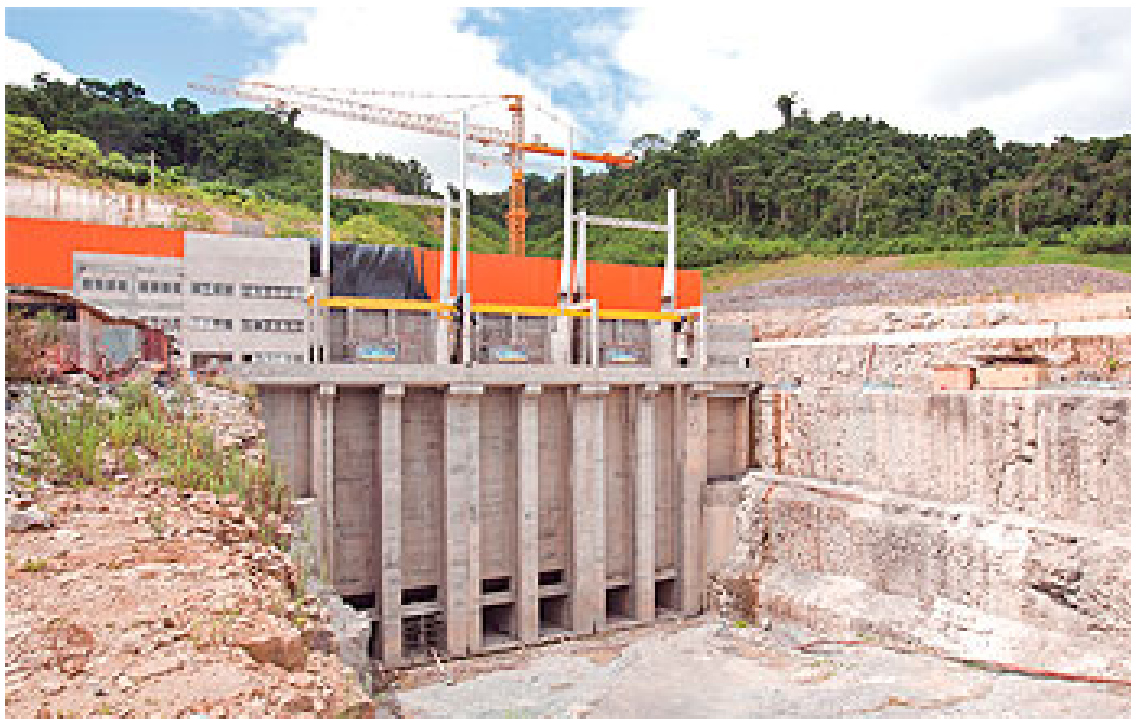
Figura 12 – Casa de força Fonte: UHE Mauá (2011)
