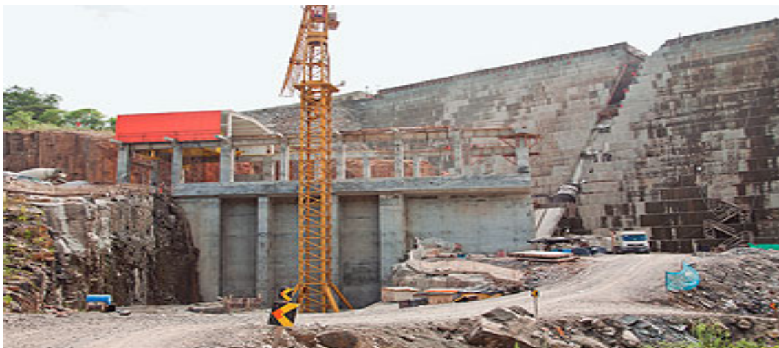
Figura 9 – Pequena Central da Usina Hidrelétrica Fonte: UHE Mauá (2011)
